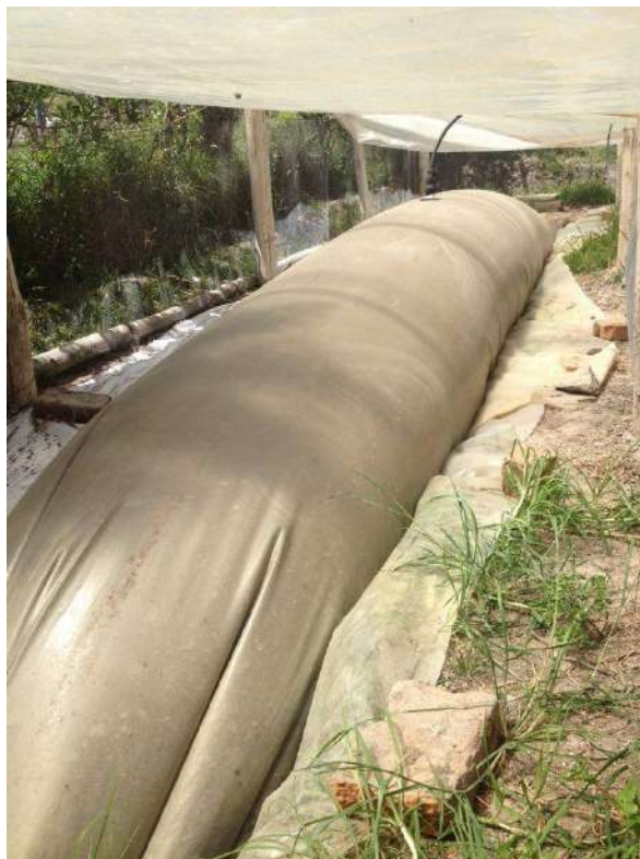
Figura 3. Biodigestor operando correctamente.
