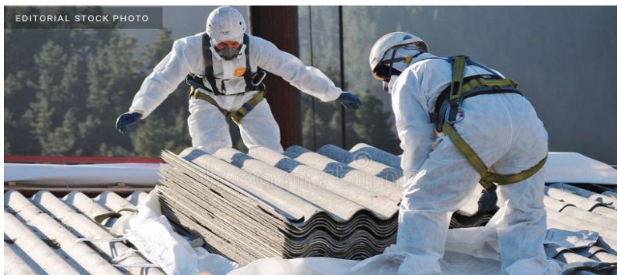
Figura 4. Exposición de trabajadores a material de construcción fabricado con asbesto.
